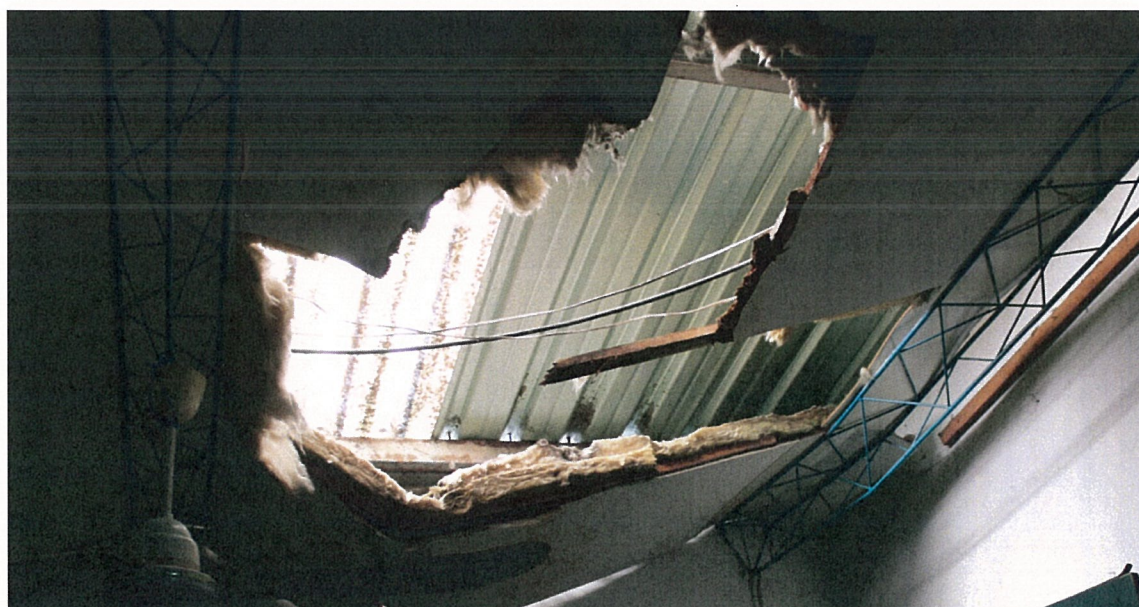
Aspecto parcial de uma zona do tecto onde são visíveis as telhas de fibra deterioradas e os efeitos das infiltrações
